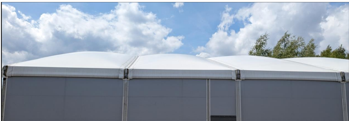
Abbildung 2: Charakteristische Wölbung des gesamten Thermoplanendachs bei vollständiger Füllung
